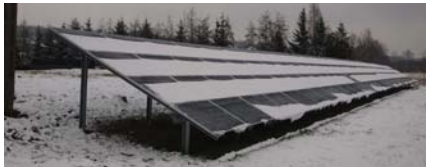
Instalacja fotowoltaiczna 40kWp na oczyszczalni ścieków
