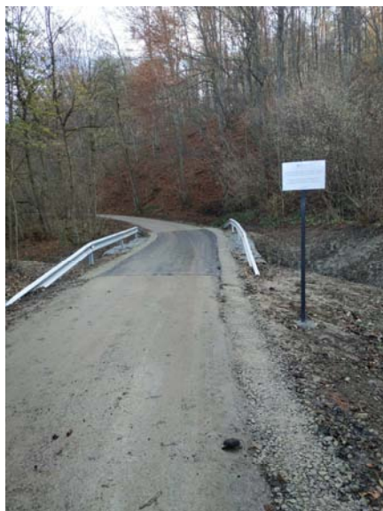
Przebudowa przepustów w ciągu drogi gminnej nr 108255R Wola Rafałowska – Grodzisko – Chmielnik w miejscowości Chmielnik w km 1+455 i w km 1+682
