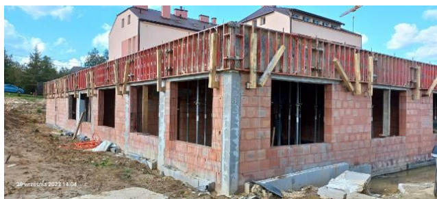
Wykonana kondygnacja skrzydła żłobkowego wraz z płytą stropową przy SP nr 3 w Chmielniku
