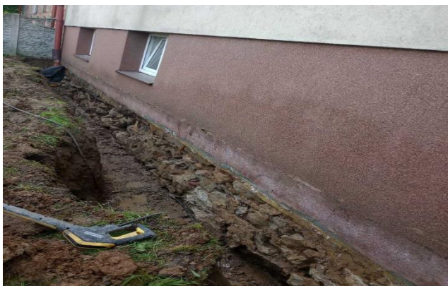
Ława fundamentowa po odkopaniu i oczyszczeniu z bardzo licznymi ubytkami.
